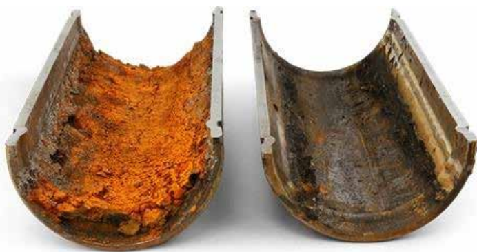
Коррозия элементов внутренней поверхности нефтепроводов
